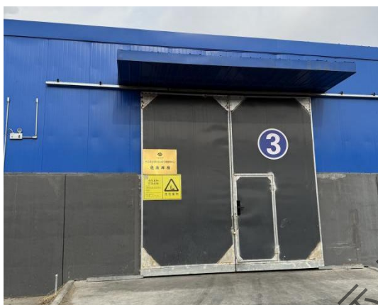
图 10-2 危险固废贮存库
