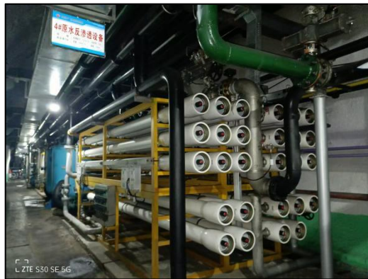
井下矿井水深度处理
