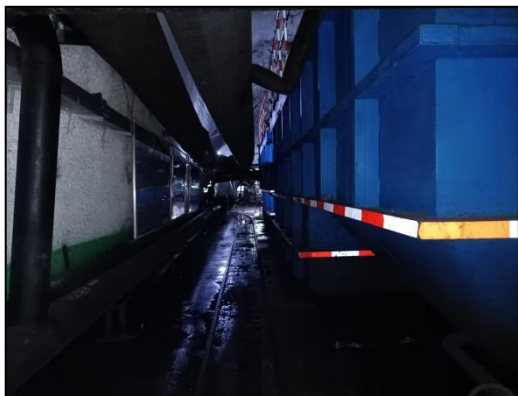
井下矿井水常规预处理
